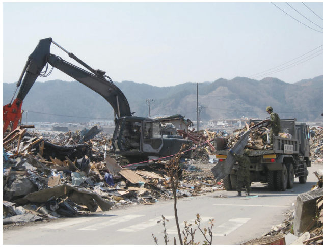
集落がほぼ全壊した安渡(あんど)地区では、自衛隊の車両がガレキを撤去して道をつけていた。
