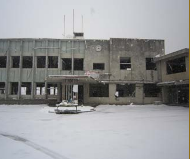
保存か解体かをめぐって多くの議論が生じている岩手県大槌町旧役場
